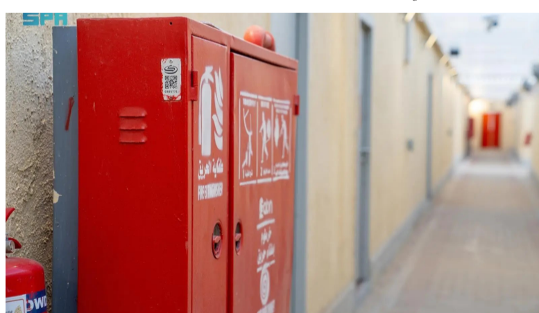
إحدى شبكات الحريق في مشعر منى
