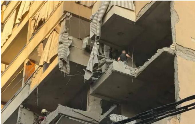
المبنى السكني الذي استهدفته إسرائيل في الضاحية الجنوبية لبيروت
