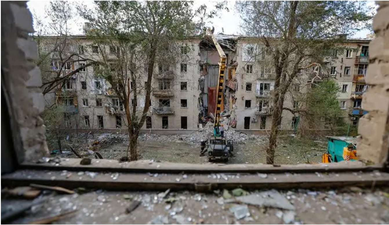
آثار الدمار على مبنى في أوكرانيا جراء القصف الروسي
